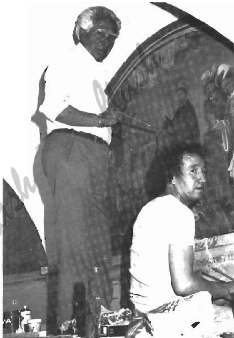
Armando Marchegiani e Marcello Sgattoni impegnati nel restauro degli affreschi del Convento di San Giacomo della Marca. Il lavoro venne eseguito 6 anni fa su incarico del Priore.
