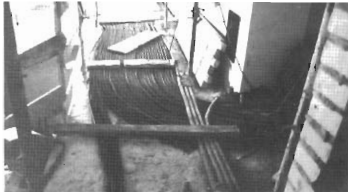
La distribuzione degli impianti elettrici: centinaia di tubi percorrono i diversi spazi del teatro senza manifestarsi.
