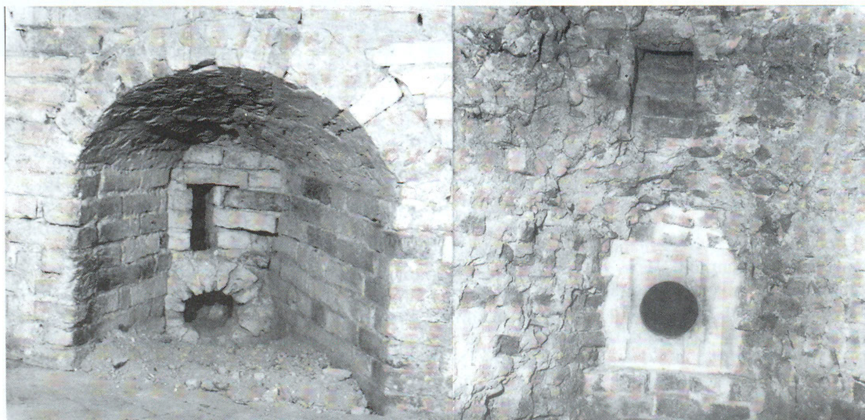
A sinistra: la troniera intatta della rocca di Acquaviva oblitterata nel 1493 per la realizzazione della scarpatura antibombarda nella parte opposta del muro. A destra: la nuova feritoia in travertino sistemata in una vecchia troniera molto danneggiata della rocca di Offida. Evidente il camino superiore per lo sfiato del fumo prodotto dalle armi da fuoco.
