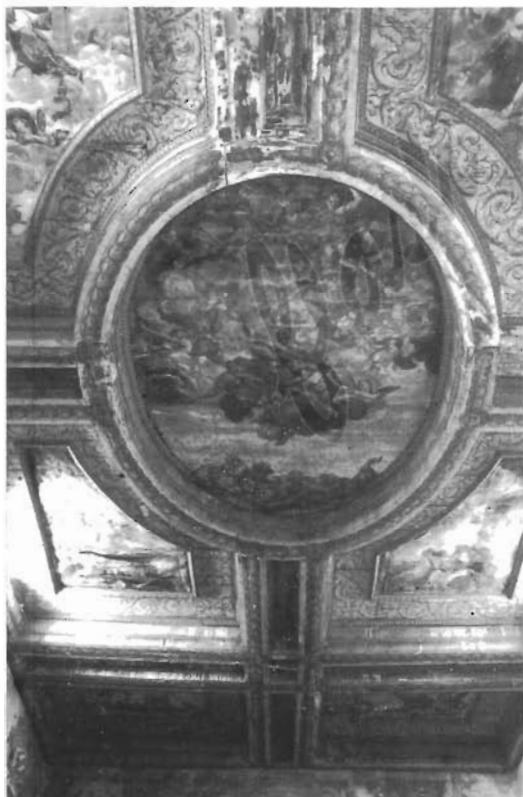
Il prezioso soffitto di Tommaso Nardini, purtroppo ridotto in pessimo stato di conservazione.
